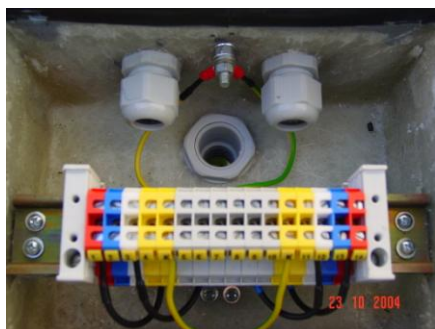
Rys. 1. Wnętrze skrzynki kablowej SK01/3/14
